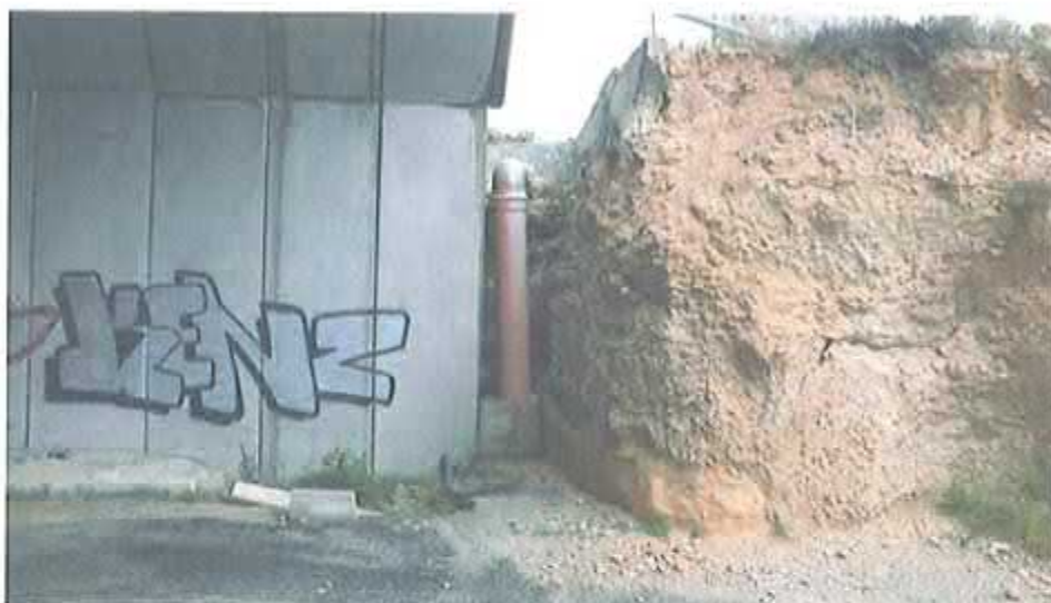
Foto 3. Red de alcantarillado del peaje, previo a la conexión con el saneamiento del Sector PP3/1
